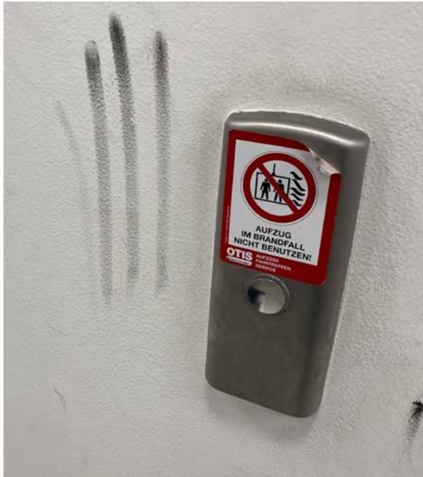
Verschmutzung der Wände in der Wohnanlage Riem
