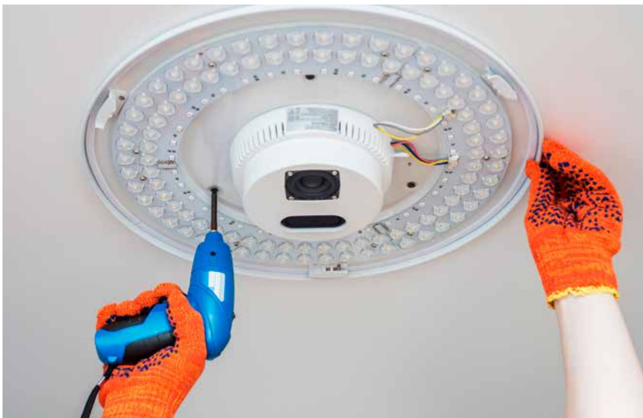
LED-Beleuchtung ersetzt die herkömmlichen Leuchtmittel
